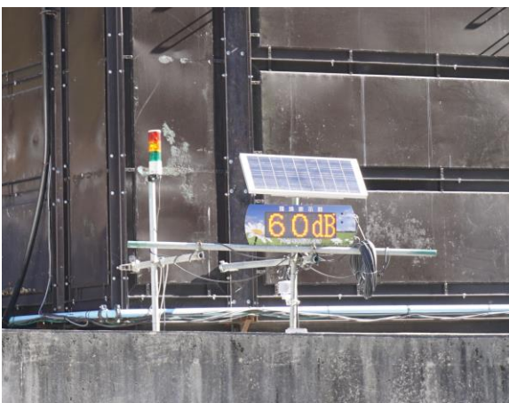
防音ハウス脇に設置された騒音計
